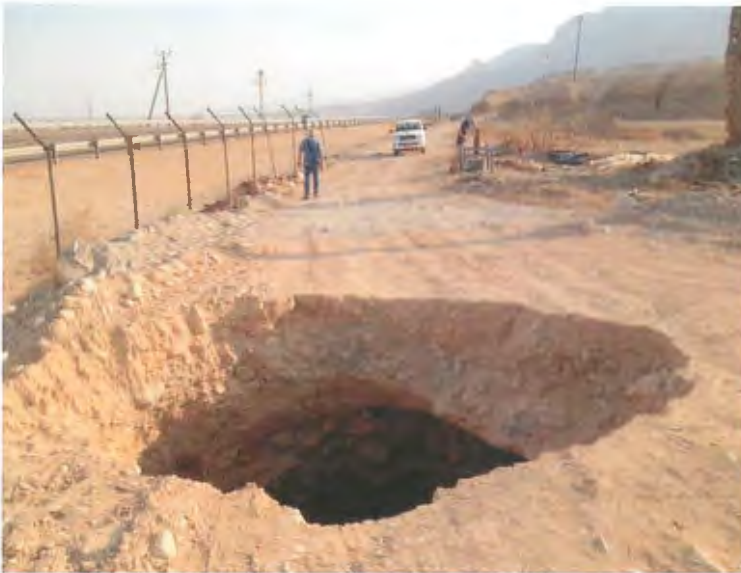
איור 25. בולען חדש באתר ערוגות בשולי כביש 90, נפער ב 2.9.2013 בסמוך לשני בולענים קודמים, באזור שהחל לשקוע כשנה קודם לכן ומאז ממשיך לשקוע. הבולענים נפתחים ומכוסים לסירוגין על ידי חברת נתיבי ישראל בע"מ.
